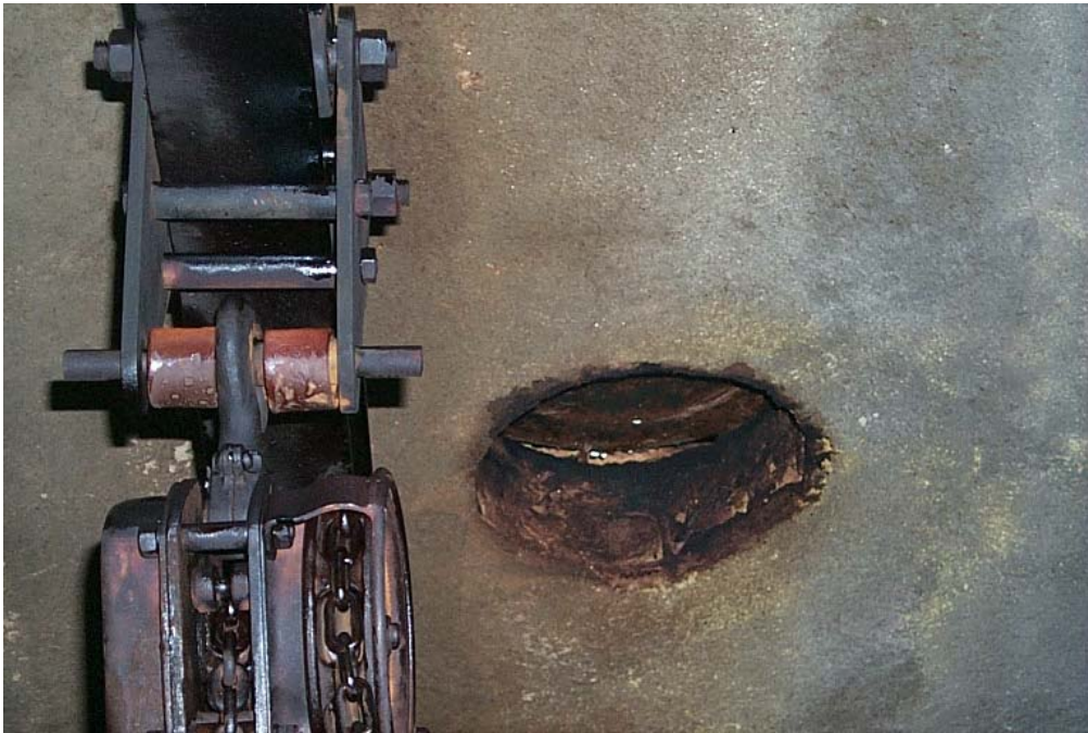
Figura 44: Foto do teto da cabina com uma abertura por onde era perdida boa parte da exaustão do sistema de ventilação
