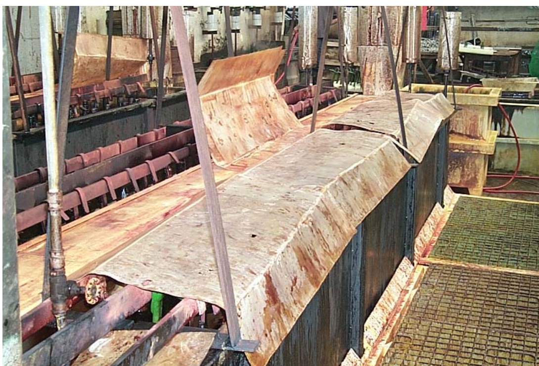
Figura 48: SVLE com tampa de fibra de vidro cobrindo os tanques eletrolíticos na empresa E 06
