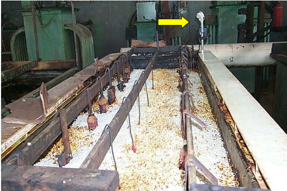
Figura 28: Foto da empresa E_{03} mostra a espessa camada de esferas de poliestireno expandido deposita sobre os banhos eletrolítico de cromação, no terceiro dia de avaliação. A seta mostra o ponto P4 de coleta
